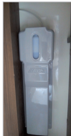
Fig.6.48 - Niveau du mélange de glycol
